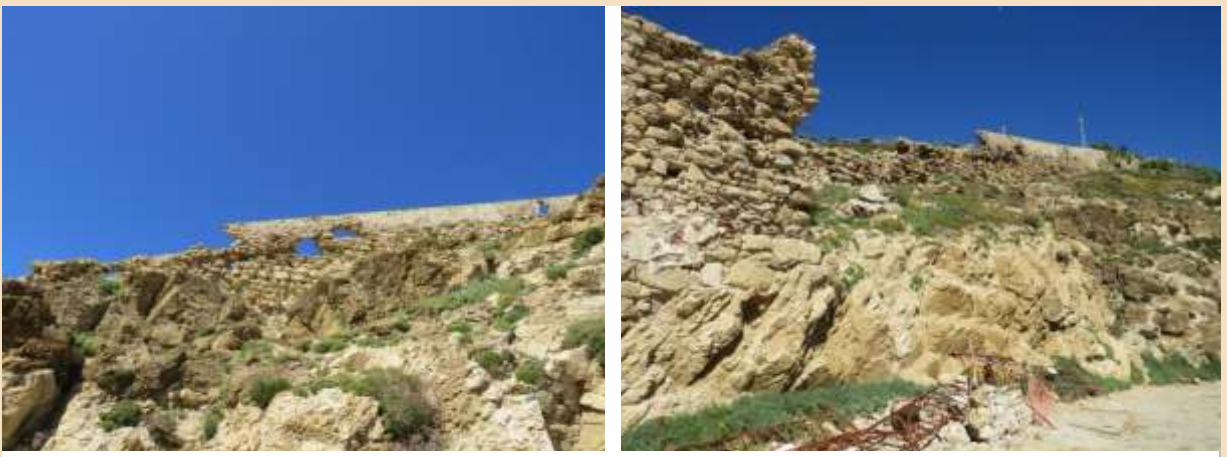
Muralla con zonas derruidas por falta del plan de protección del conjunto histórico que afectaría a estas murallas .
