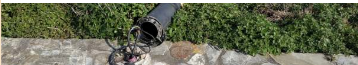
Imágenes del estado deteriorado de los accesos y servicios de la isla.
