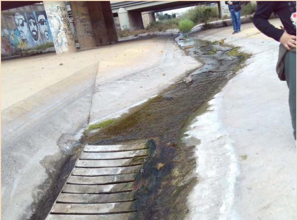
Alcantarilla a escasos metros de la desembocadura del río de Oro, en la playa de San Lorenzo.
